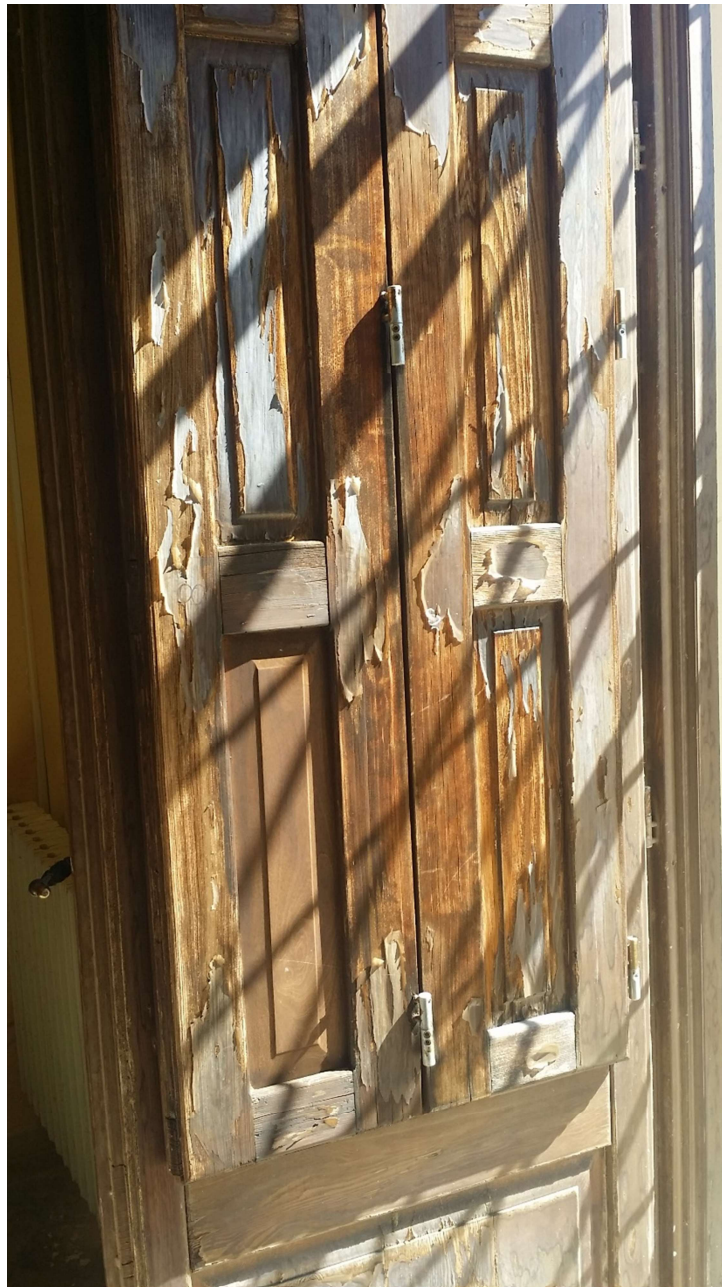
Stato degli infissi esterni
