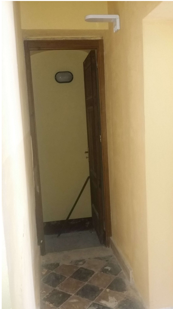
Porta da sostituire con porta in ferro
